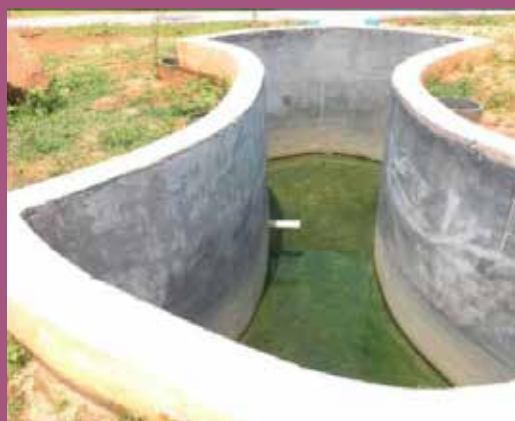
The Polishing Tank, FSTP
